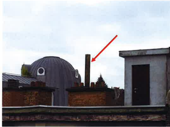
Photos 1 et 2: Gaine amiante-ciment
